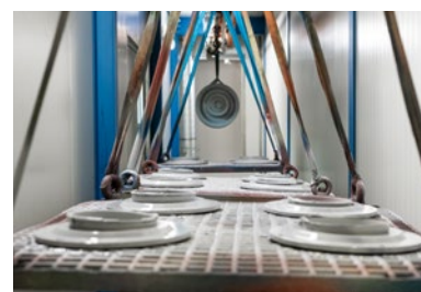
Blik in de halfautomatische drooginstallatie
